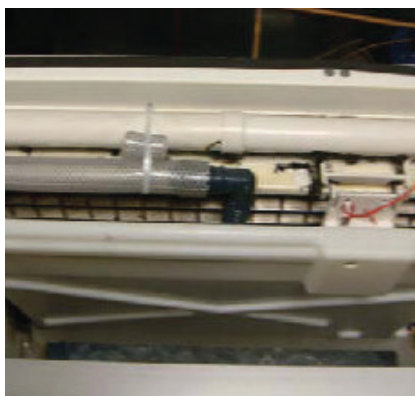
Før test og rengøring var der synlig mikrobiel vækst.
